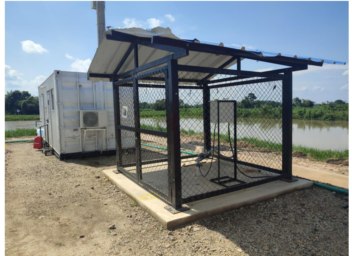
Pozo de agua profundo dentro de la Plataforma Multipozo Saltador del APE Llanos 123
