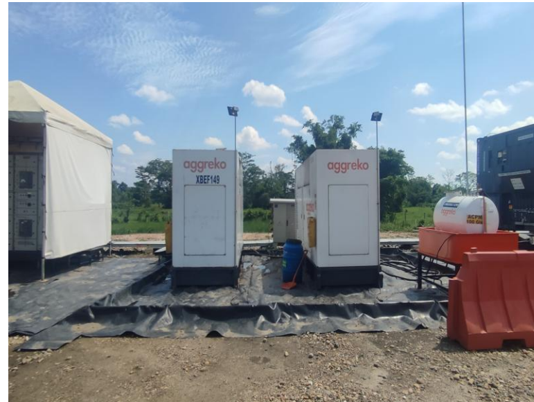
Área de generadores de la Plataforma Multipozo Saltador
