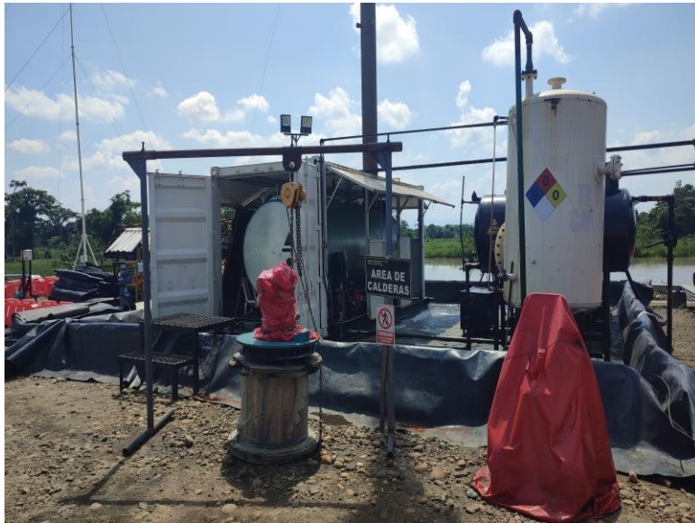
Área de caldera de la Plataforma Multipozo Saltador
