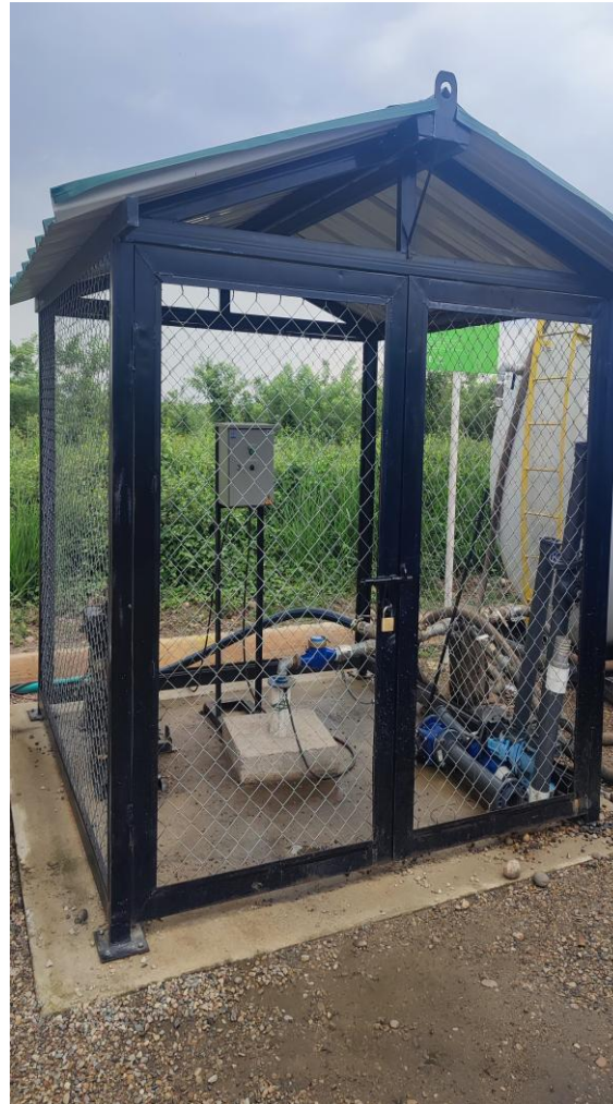
Pozo de agua profundo dentro de la Plataforma Multipozo Toritos del APE Llanos 123
