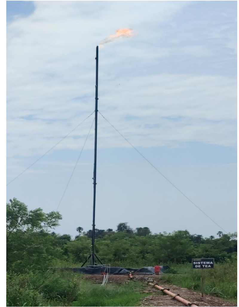
Sistema de Tea de la Plataforma Multipozo Toritos
