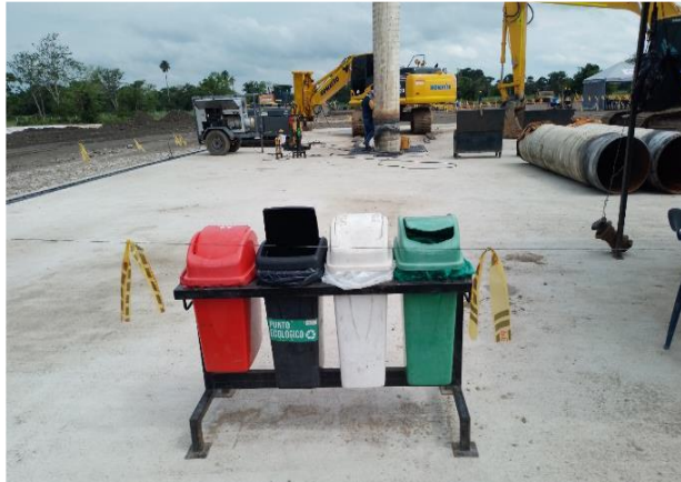
Punto ecológico para clasificación de residuos de la Plataforma Multipozo Saltador
