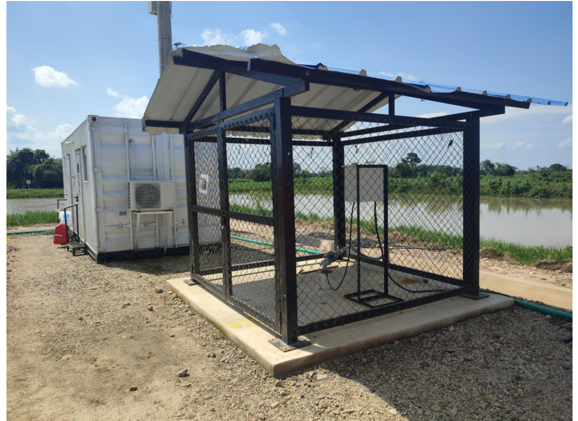
Pozo de agua profundo dentro de la Plataforma Multipozo Saltador del APE Llanos 123
